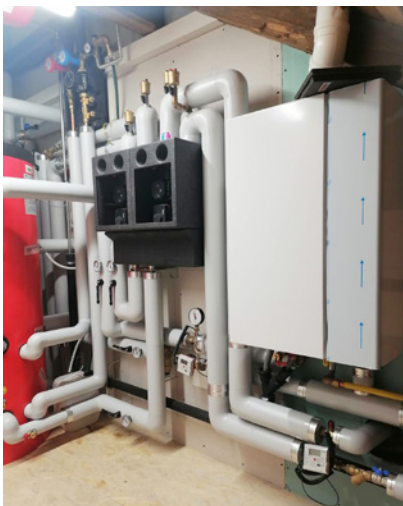
Die Änderung der Kontrollrichtlinien betrifft auch Heizungsanlagen © BG HLS-Techniker/innen im lvh
